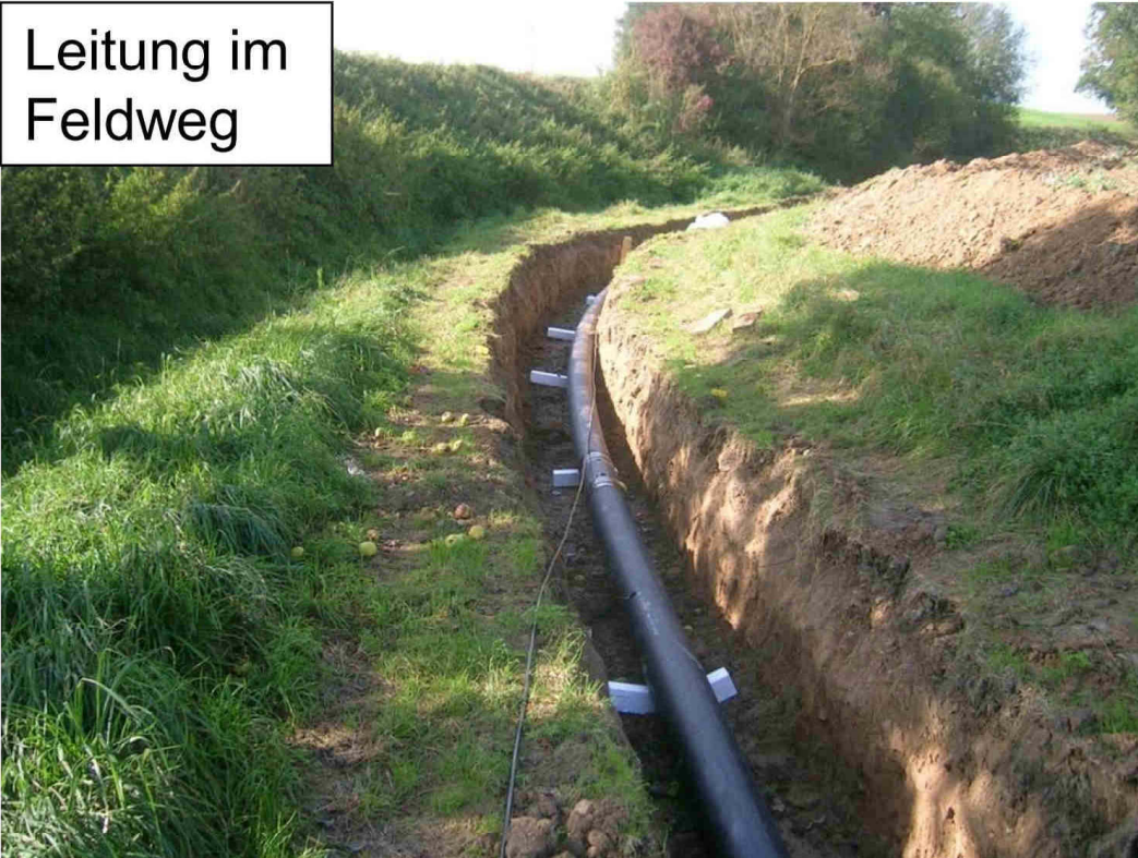
Wärmeleitung im Straßenbereich
